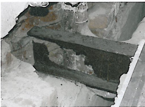
Nicht mehr viel übrig: Von Korrosion stark dezimiertes Stahlträgerelement
