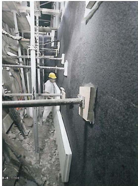
Abb. 8: Zeitaufwändiges Umsetzen der Spindeln, die das Aufbringen der Schutz- und Dämmplatten behinderten.
