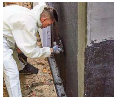
4 Die Dämmplatten schützen die Abdichtung vor Beschädigungen beim Auffüllen des Erdreichs. Sie verbessern auch den Wärmedämmwert und damit die Energiebilanz des Gebäudes erheblich.
