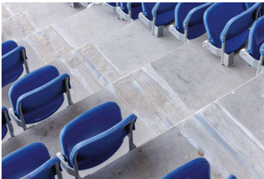
Nach der Abdichtung der Dehnungsfugen bei den Betontreppen sind die Wasserschäden gebannt.
