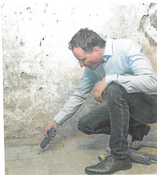
Vor der Sanierung wurde der Feuchtegehalt im Boden und in den Wänden des mehr als hundertjährigen Hauses gemessen für eine umfassende Schadensanalyse.
