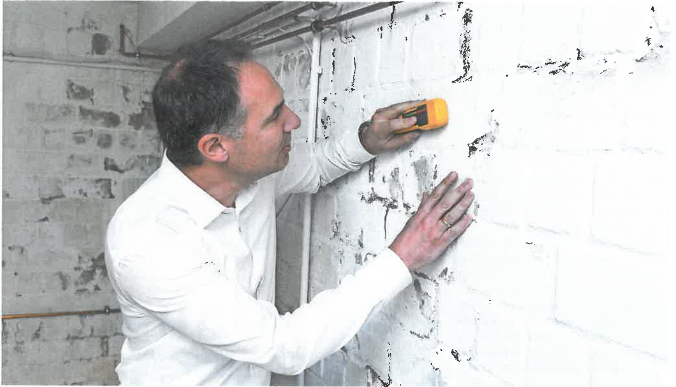
Feuchteschäden führen im Keller zu Putzabplatzungen.
