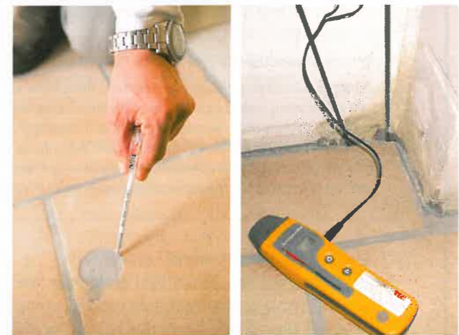
Analyse Nach den Ergebnissen einer Luftmessung werden bei Bedarf Proben aus dem Kellerboden genommen. Wände und Kellerboden sind typische Kandidaten für Feuchtigkeitsschäden.
