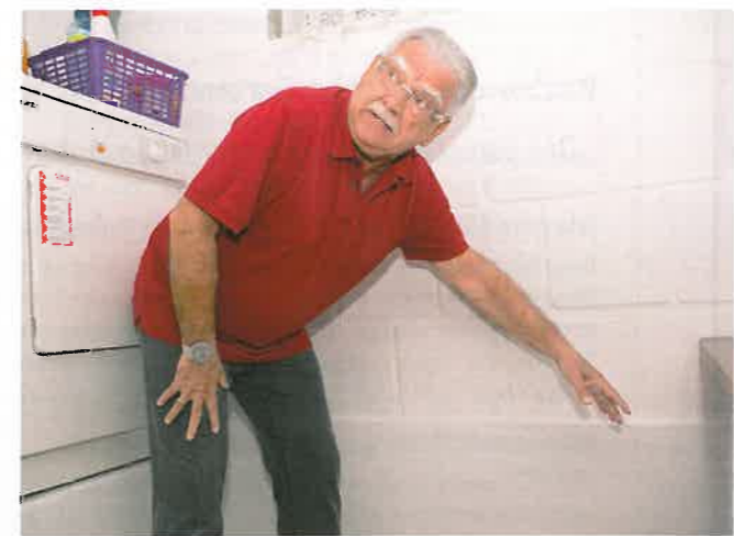
Feuchte Wände Bräunliche Stellen zeigten hier einen Feuchtigkeitsschaden an. Intensives Lüften und Überstreichen blieben ohne Wirkung. Die Feuchtigkeit stieg 60 bis 70 Zentimeter an der Wand hoch.
