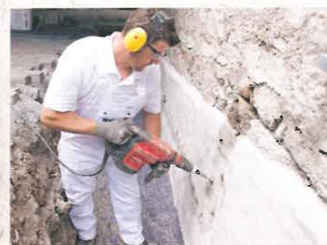
Um die Paraffin-Injektion vornehmen zu können, werden Löcher ins Gemäuer gebohrt.
