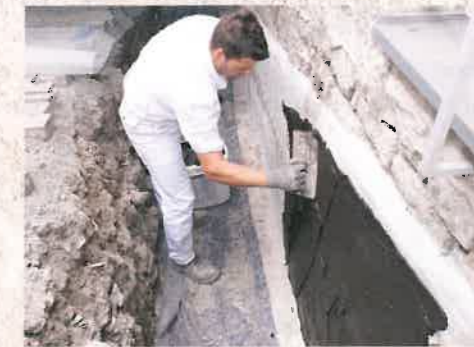
Die Kelleraußenwand wird mit einer modifizierten Bitumendickbeschichtung versehen. Hier beginnt der Sanierungsprofi mit dem Auftragen der ersten von zwei Lagen.
