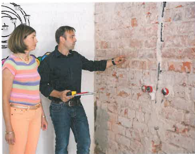
Das Untergeschoss eignet sich letztlich nur dann als Wohnraumreserve, wenn die Kellerwände trocken sind. Bei vielen älteren Häusern ist das nicht der Fall.
