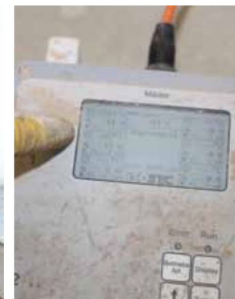
► Die Wandtrocknung wird über das Regelgerät gesteuert.
