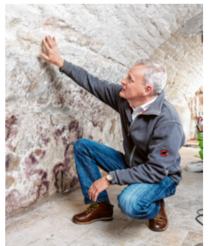
Wenn Feuchtigkeit ins Mauerwerk eindringt, sollten Fachberater hinzugezogen werden. Foto: oH
