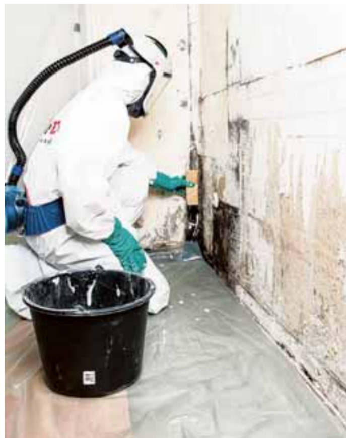
Sind größere Stellen vom Schimmel befallen, sollte eine Fachfirma eingeschaltet werden. Foto: ISOTEC
