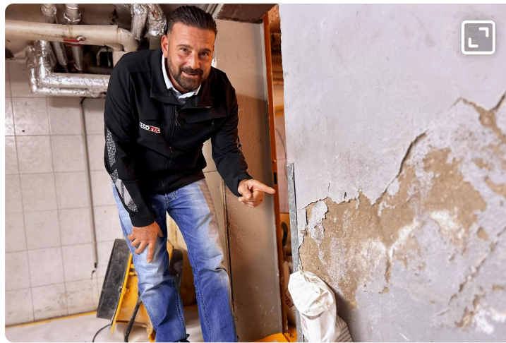
Bauleiter Vincenzo Multari zeigt: So sah nahezu der gesamte Keller aus: Feuchtigkeitsschäden, abblätternde Farbe, Schimmel. © Petra Zimmermann
