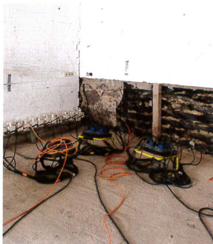
Mehrere Gebäude der Schlossanlage waren von aufsteigender Feuchte betroffen.
